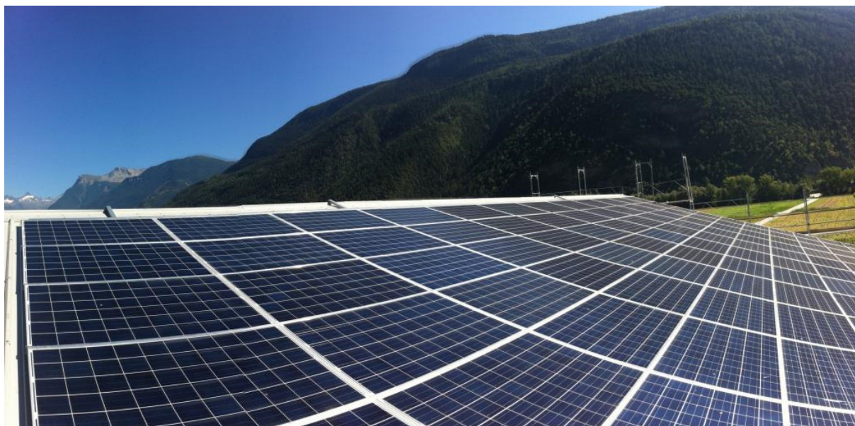
Photovoltaikanlage Hangar, Raron
